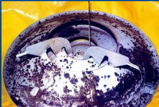
Ανάπτυξη μούχλας στον καταναεμητή αέρα της οροφής.
