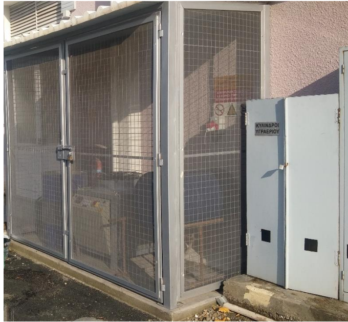
Εικόνα 9: Εξωτερικός στεγασμένος χώρος για τον ψύξη και το βαρέλι διχλωμομεθανίου
