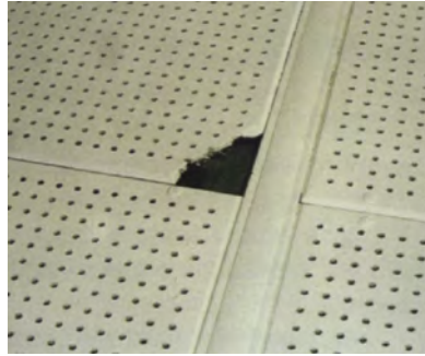
Ψευδοροφή από πλάκες που περιέχουν αμίαντο
