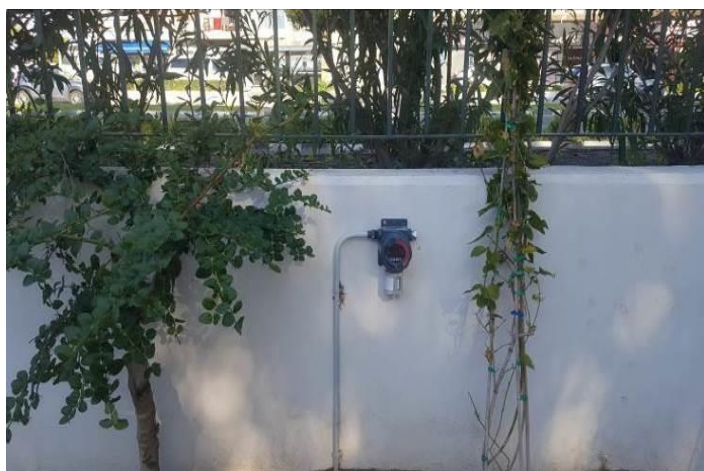
Μετρητής αερίων στο περίγυρο αντλιοστασίων
