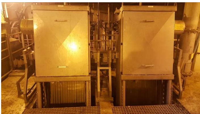
Αυτόματο σύστημα σχαρών
