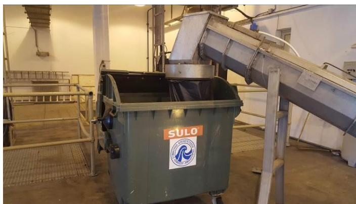
Αυτόματη απόρριψη σχαρισμάτων σε κάδο.
