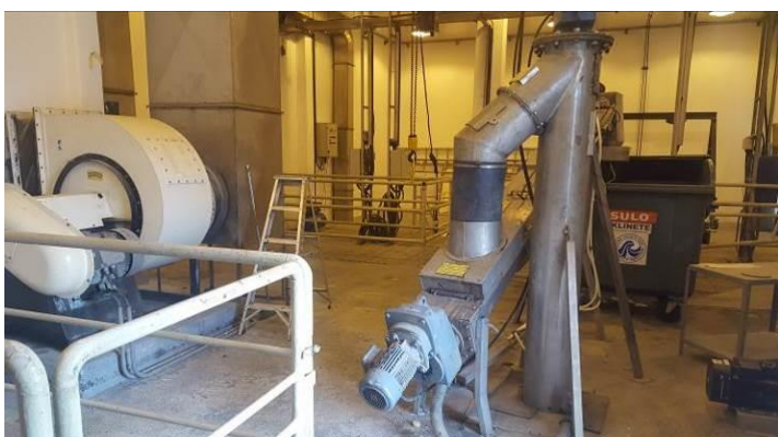
Σύστημα αυτόματης απομάκρυνσης σχαρισμάτων
