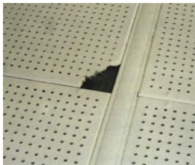
Ψευδοροφή από πλάκες που περιέχουν αμιάντο
