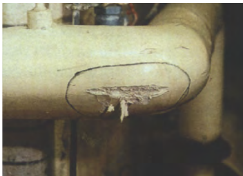
Σωλήνα με μόνωση αμιάντου
